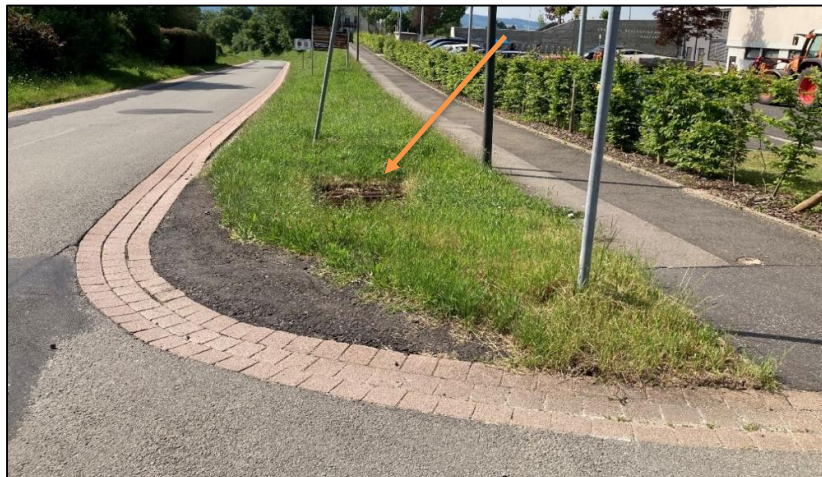
Abbildung 71: Schlecht anströmbares Einlaufbauwerk am Straßenrand der Hauptstraße
