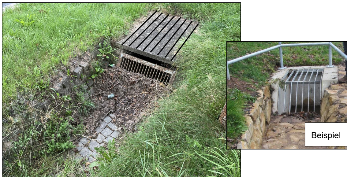
Abbildung 73: Verklautes Einlaufbauwerk im Straßengraben mit skizzierter Darstellung eines mehrdimensionalen Einlaufbauwerkes und Beispielfoto
