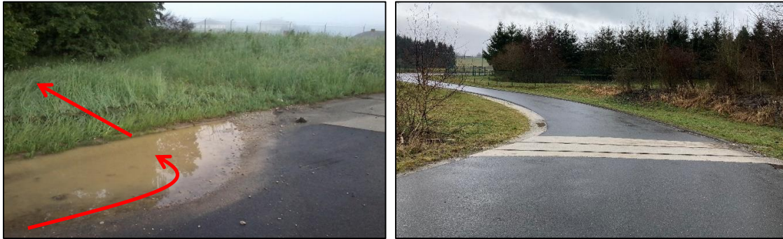
Abbildung 110: Tiefpunkt an der Bahntrasse nach dem Regenereignis (links) und bei Trockenwetter (rechts)
