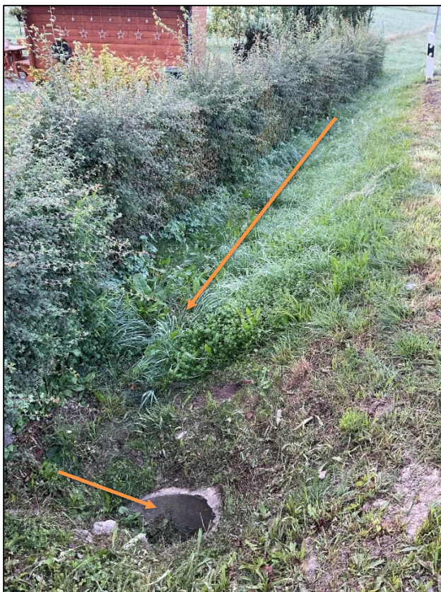
Abbildung 120: Hydraulisch ungünstiger Verrohrungsbeginn im Straßengraben der K114
