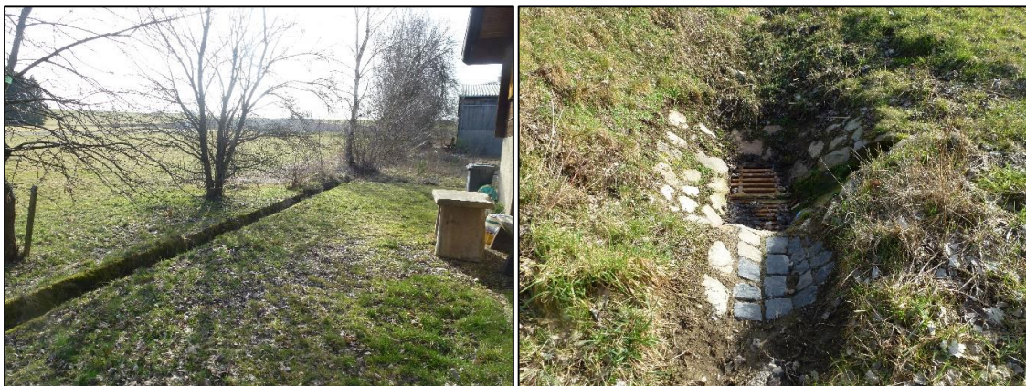
Abbildung 102: Befestigter Graben (links) mit Einlaufbauwerk (rechts)
