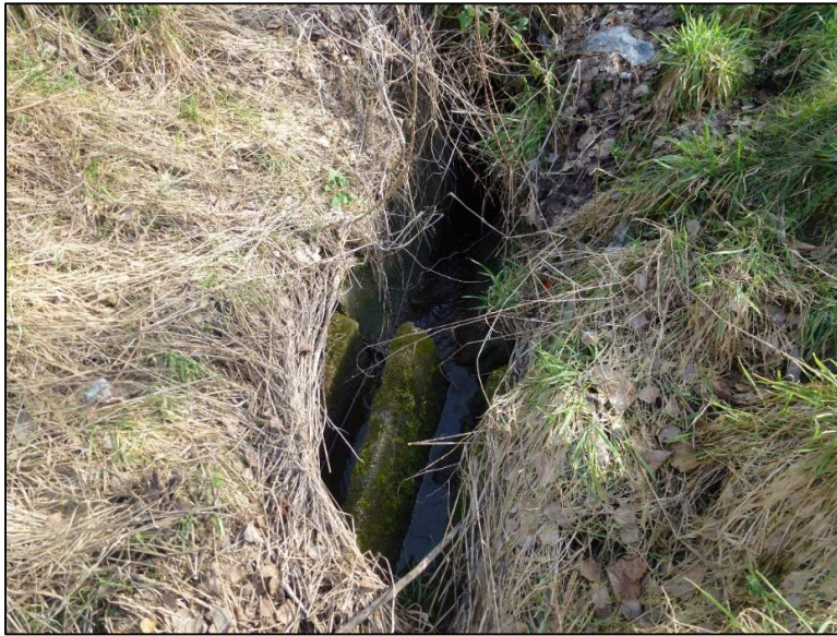
Abbildung 94: Aufgebrochene Halbschalen im Gewässerbett
