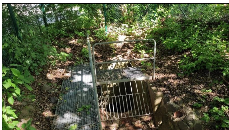
Abbildung 97: Beispiel eines mehrdimensionalen Einlaufbauwerkes inkl. Geländer
